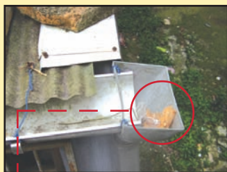
排水溝堆積雜物
